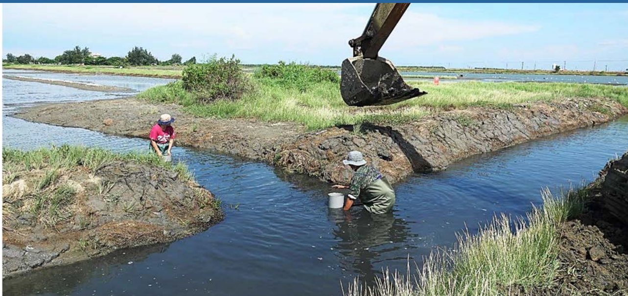
| 10-7 埋設 PVC 連通管以調控水位
