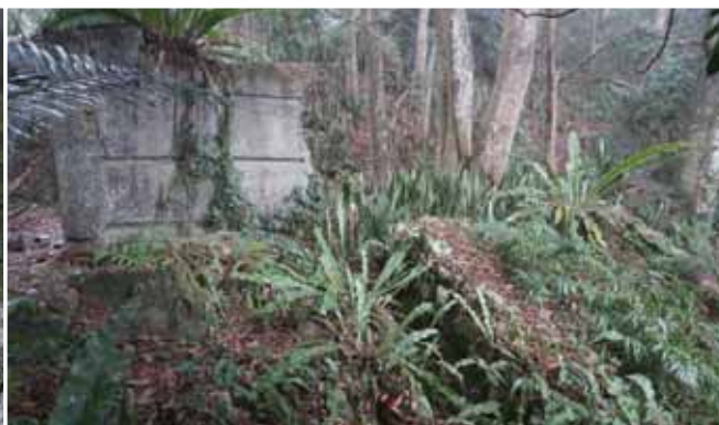
象鼻古道護管所，石砌牆面已有部分傾倒
