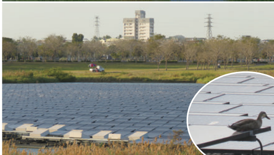
典寶溪B區滯洪池有兩座光電板
