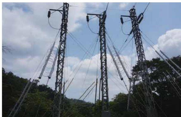
66號高壓電塔基座
